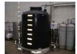
殺菌水貯留槽
